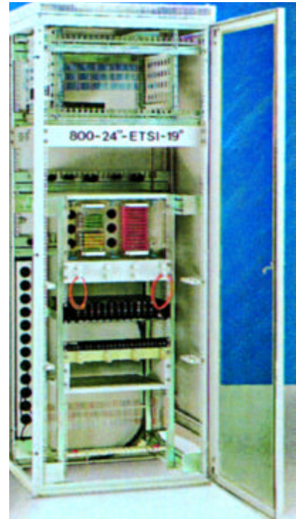
Επιδαπέδιος κατανεμπτής (Rack)
